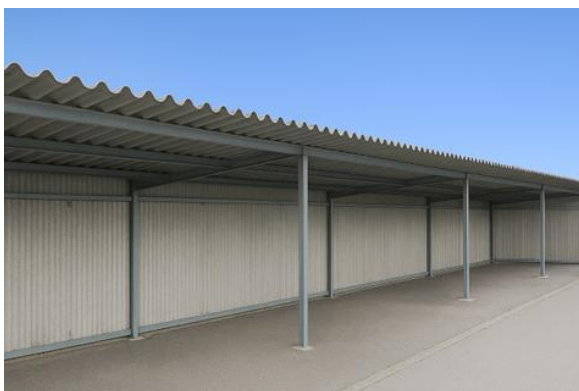
Figura 7 - pensilina in cemento-amianto
