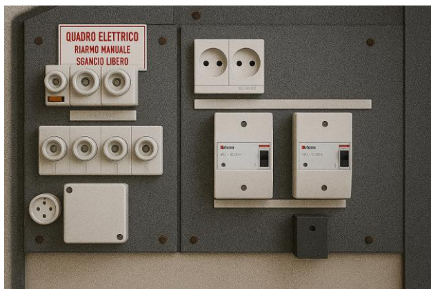
Figura 8 - quadro elettrico con lastre in cemento-amianto
